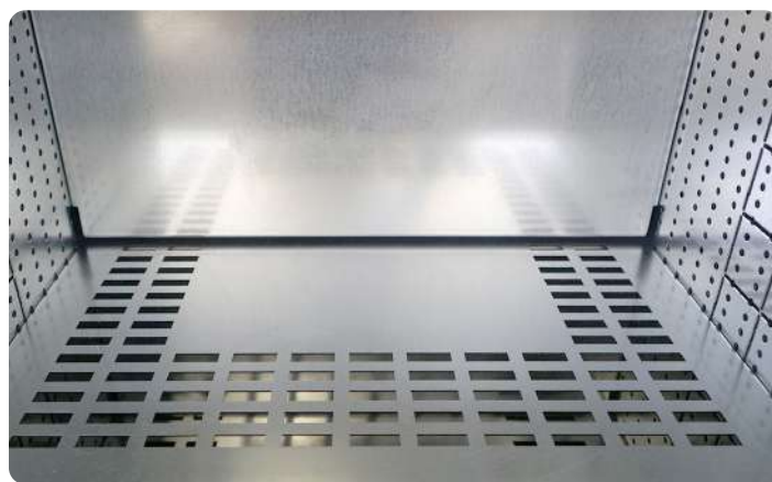
L'interno degli scomparti è studiato per contenere tutti i componenti necessari per l'avviamento, il controllo e la protezione del motore.
