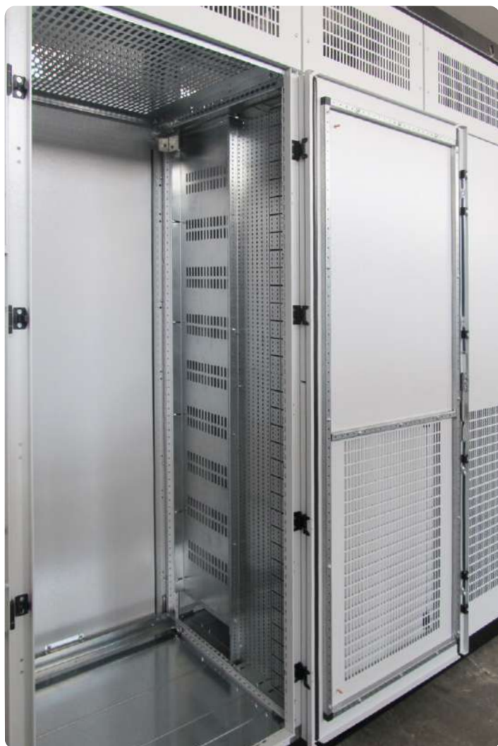
Discesa sbarre segregata e posizionata nella parte posteriore del quadro
